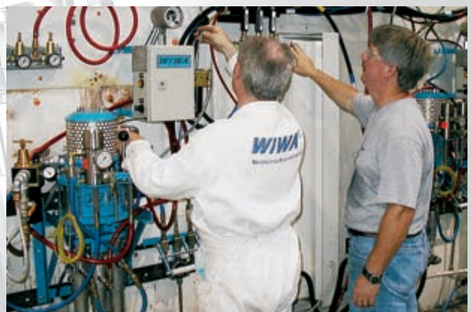
Mise en service d'une installation DUOMIX aux USA
